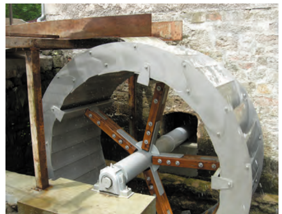
Wasserrad in Frohnbach, Neubau, 6 kW
