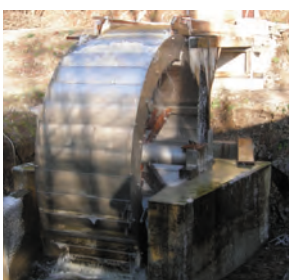
Wasserrad in Betrieb, 11 kW Leistung
